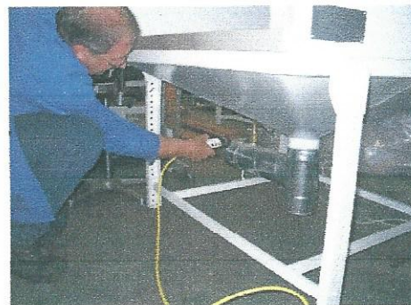
Schutzleiterprüfung am Strömungssensor
